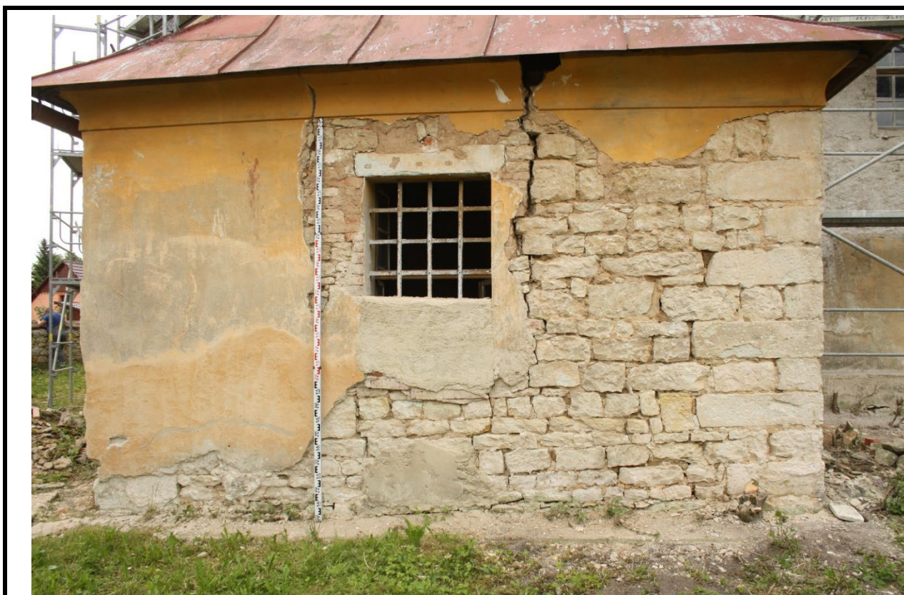
Severní průčelí sakristie v pohledu od severu s patrným armováním severozápadního nároží. Na překlad okna byla druhotně využita stojka ze středověkého obdélného okna. Foto: Jaroslav Skopec 2015.
