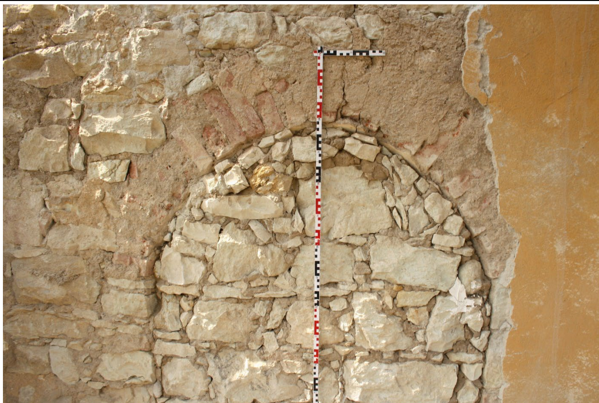
Detail záklenku zazděného hrotitého okna v severovýchodním poli závěru presbytáře. Foto: Jaroslav Skopec 2015.
